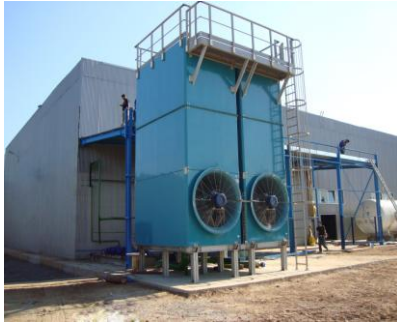
Tour de refroidissement
