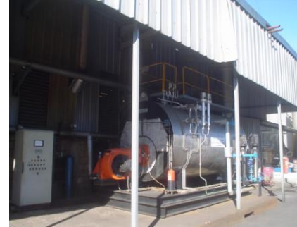
Chaudière et circuit vapeur
